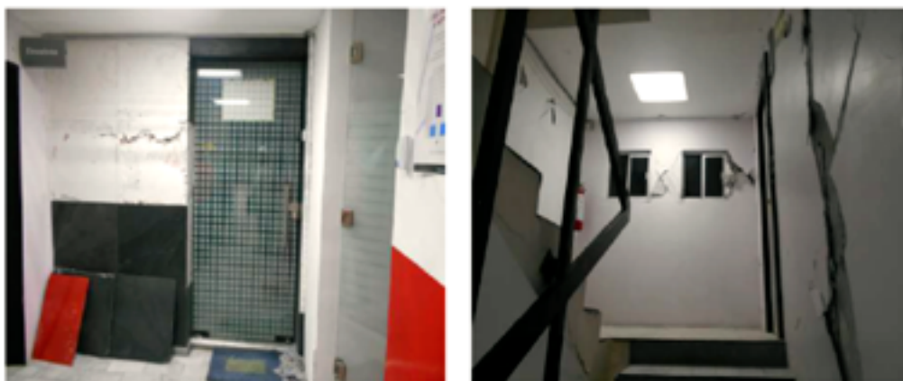
Los daños son evidentes en el edificio por lo que están a la espera de los resultados del peritaje para saber si es habitable o tiene daños estructurales.
