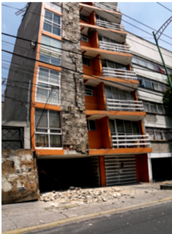
Edificio dañado por el sismo de septiembre 2017, en Ciudad de México. Fuente: Fotos compartidas por los miembros del comité y grupos de trabajo daños AMIS
