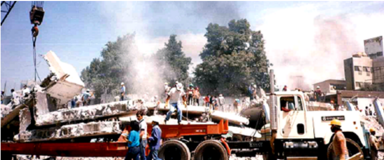
Trabajos de demolición y retiro de escombros de los edificios dañados. Fuente: Fotos compartidas por los miembros del comité y grupos de trabajo daños AMIS
